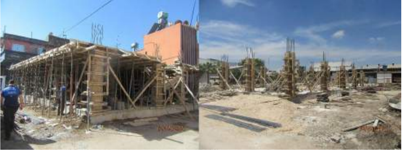
Resim: Kaçak Yapı
